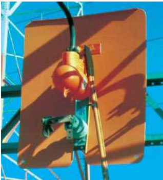
Protector de mordaza con barrera e interruptor instalado en un interruptor de subestación.
